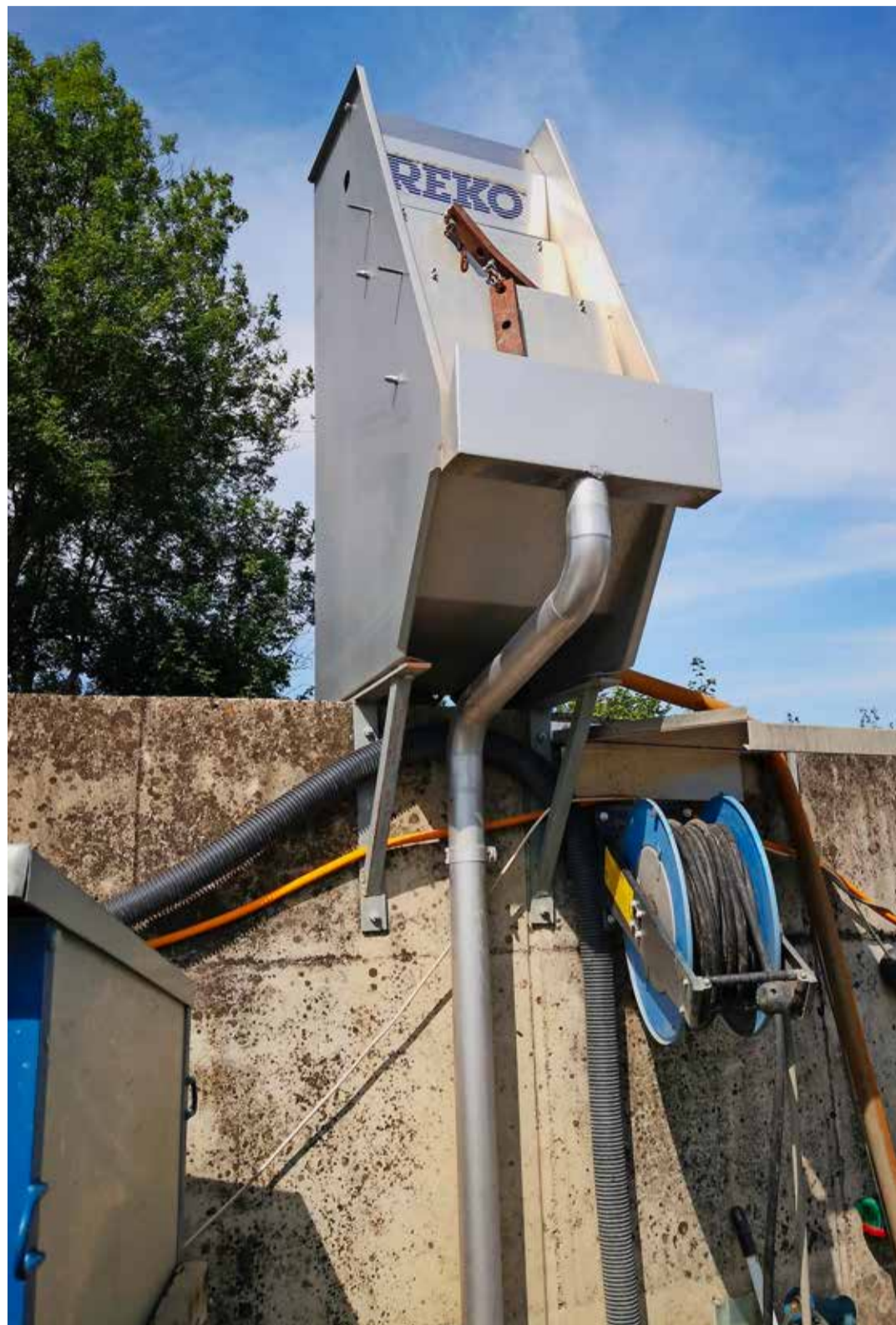
Système de cribles permettant de filtrer les eaux de lavage.
